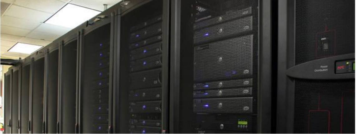
Şekil.7. Veri merkezinde barındırılan sunucular.
