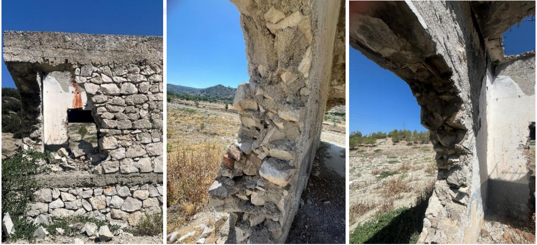
Şekil 6.2.14.11., Şekil 6.2.14.12., Şekil 6.2.14.13. Kuruçay Köyü Okulu Duvar Detay Fotoğrafları (Yılmaz Özev Arşivi, 2024)
