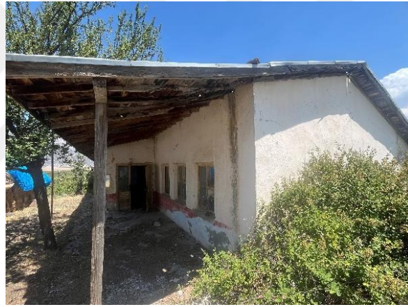
Şekil 6.11.2.6. Yeşilova Bayındır Köyü Okulu Güney Cephe Fotoğrafı (Yılmaz Özev Arşivi, 2024)
