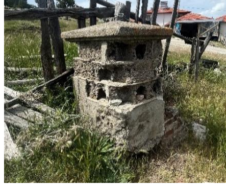
Şekil 6.2.1.15. Başmakçı Köyü Okulu Bahçe Duvarı Fotoğrafı (Yılmaz Özev Arşivi, 2024)
