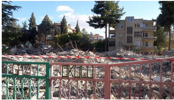
Şekil 6.1.1.11. Yıkılan Gazi Okulu'nun Fotoğrafı (URL-11, 2025)
