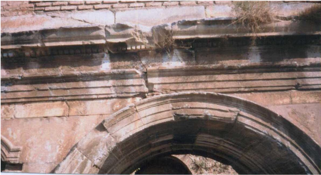
Şekil 5. MS117-138 yılları arasında imparator Hadrianus zamanında yapılan İznik'deki İstanbul Kapı'da deformasyon izleri (Adatepe Arşivi, Adatepe ve Erel 2006'dan alınmıştır).
