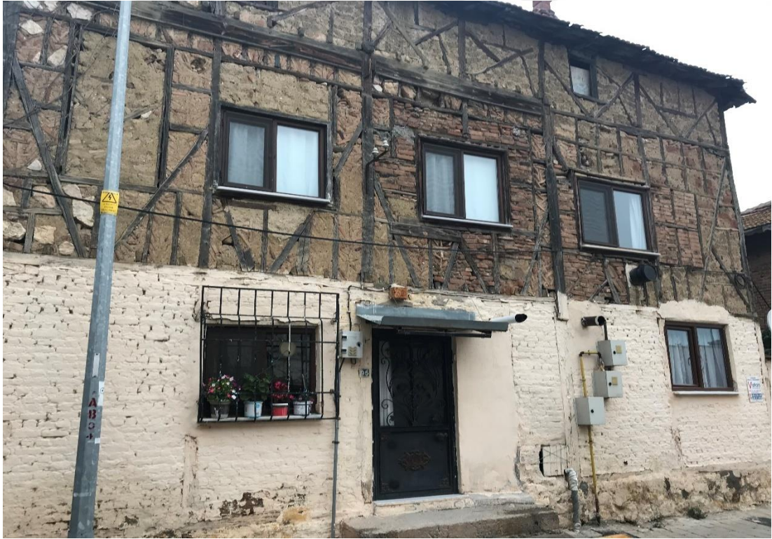
Şekil 4.179: Gölyazı mahallesinde doğalgaz altyapısına sahip olan tarihi bir konut
