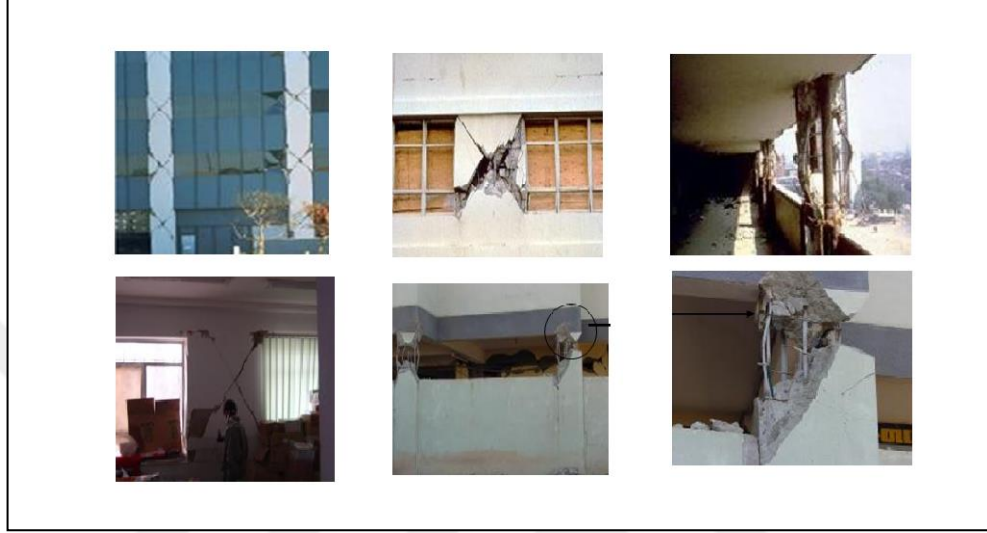
Şekil 1.27 Kısa kolonlardaki hasarlar
