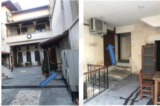
Şekil 112. Zeynep Hanım Konağı avlu klima üniteleri(Orijinal,2018)
