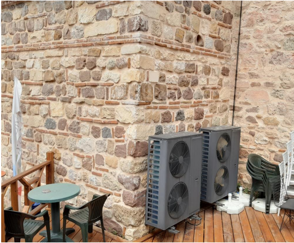
Şekil 4.4. Süleyman Paşa Hamamı'nın restoranında kullanılan HVAC sistemleri (Kişisel Arşiv).
