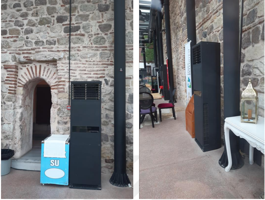
Şekil 4.3. Süleyman Paşa Hamamı'nın restoranında kullanılan HVAC sistemleri (Kişisel Arşiv).
