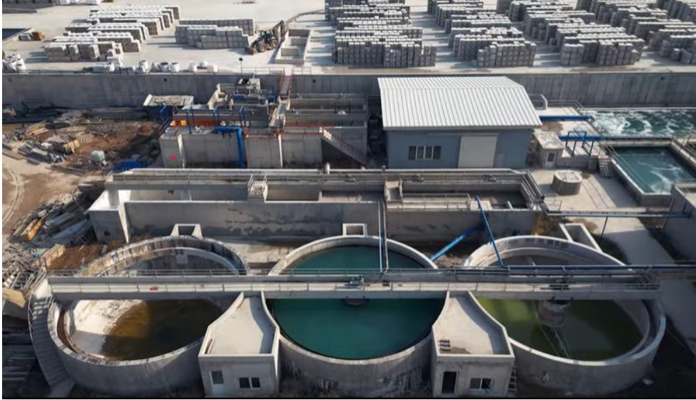
Atık Su Arıtma Tesisi
