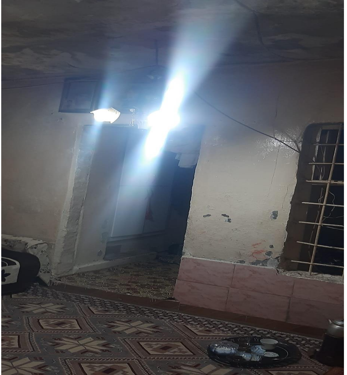
Fotoğraf 10 Aynı evin oturma ve yatma odası, tavandan yağmur suyu damlama yapmakta ve aşırı rutubet ve ışıksız bir ortam.
