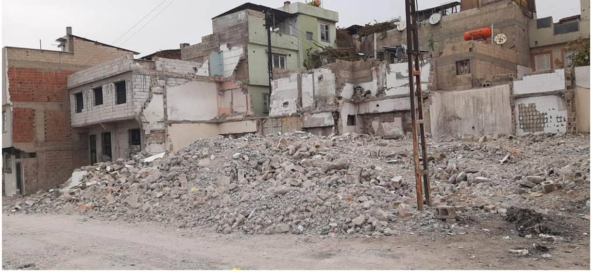
Fotoğraf 5 Karşıyaka Mahallesi kentsel dönüşüm projesinden dolayı yıkılan evler.
