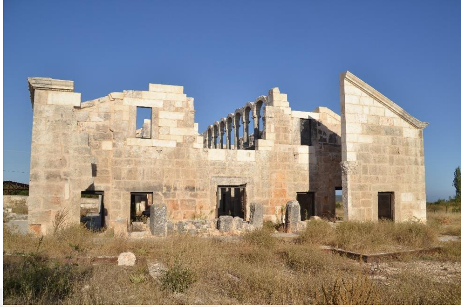
Fotoğraf 7. Narteksin batı duvarının tahrip olmuş bölümü (Olba Kazı Arşivi)
