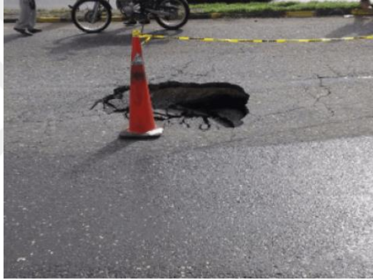
Şekil 2.9. Bölgesel çökme örneği
