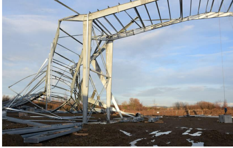
Şekil 1.5. Yatay stabiliteyi sağlamayan yapının göçmesi (Investigations Into Steel Structure Failures Part II: Case Studies)
