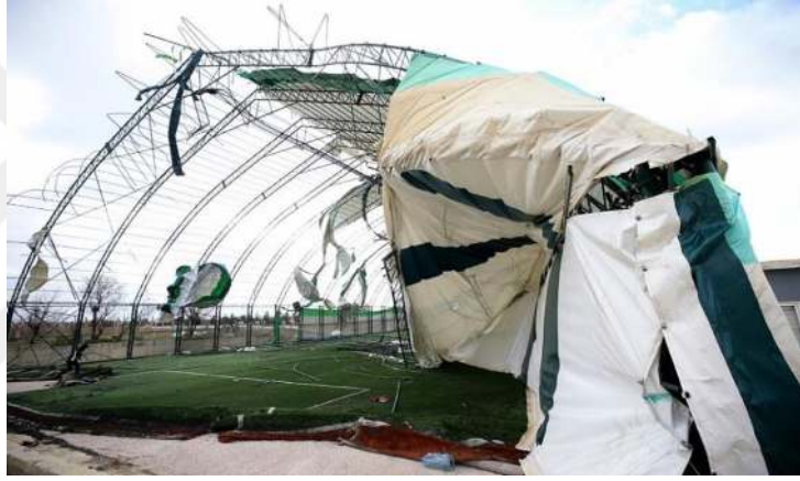
Şekil 1.6. Aşık tasarımında rüzgâr yükü dikkate alınmamasından dolayı lokal aşık göçmesi (Anadolu ajansı Kırklareli Murat Baytaroğlu spor saha tesisi 2022)
