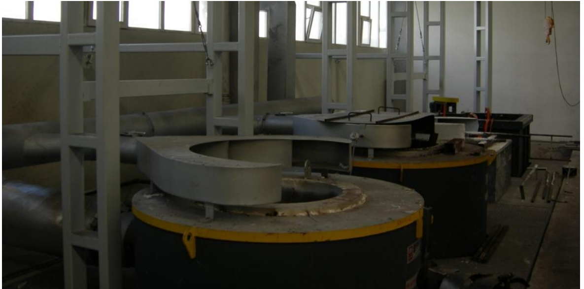
Şekil 2. 26. Isıtım işlem ünitesi genel görünüş
