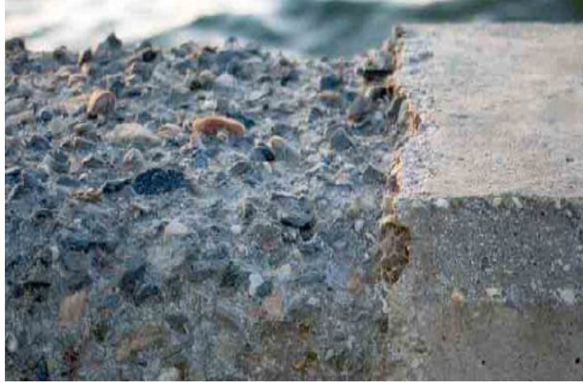
Şekil 2.10. Deniz suyu etkisindeki liman betonunun görünümü
