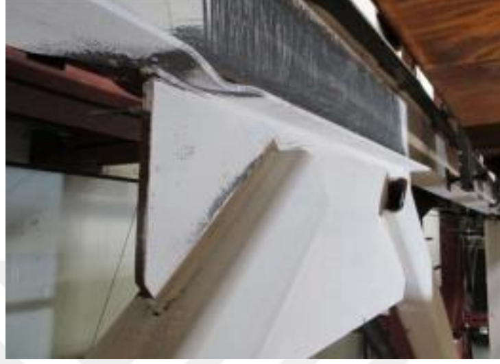
Şekil 2. Hasarlı bir bağ kirişinden görünüm (Demir, 2018)
