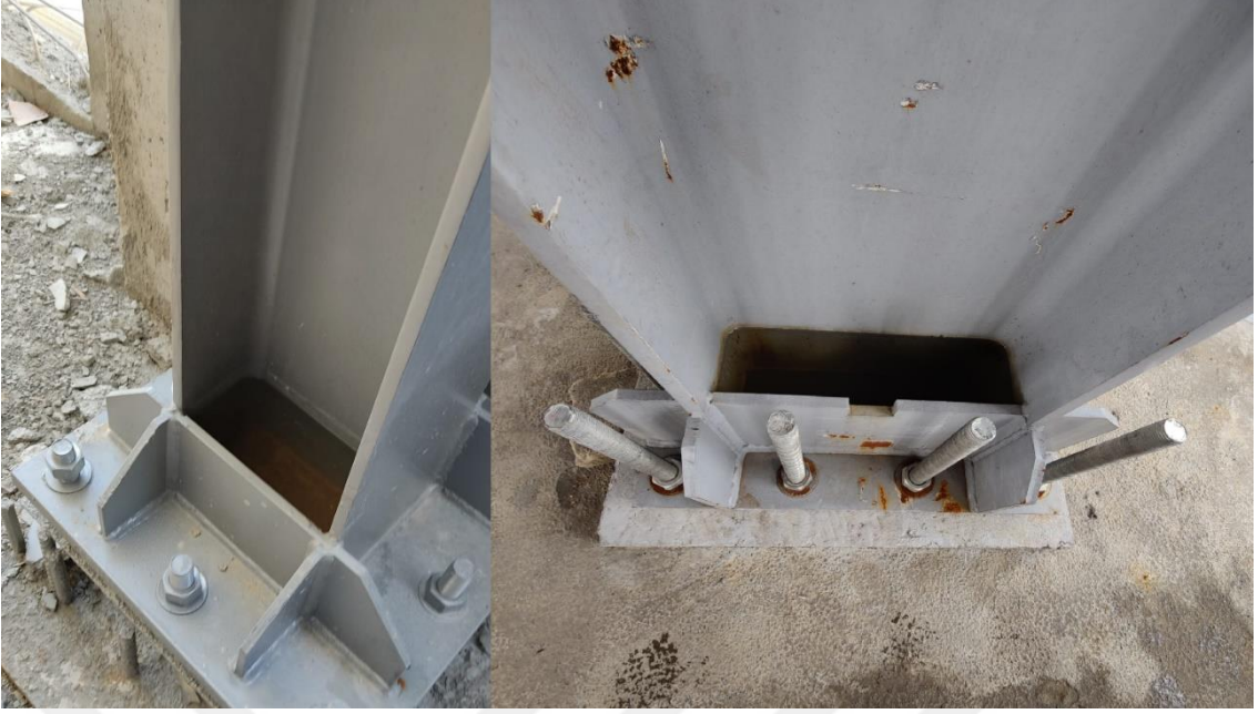
Şekil 3.4. Tahliye edilemeyen suyun taban levhasında birikmesi
