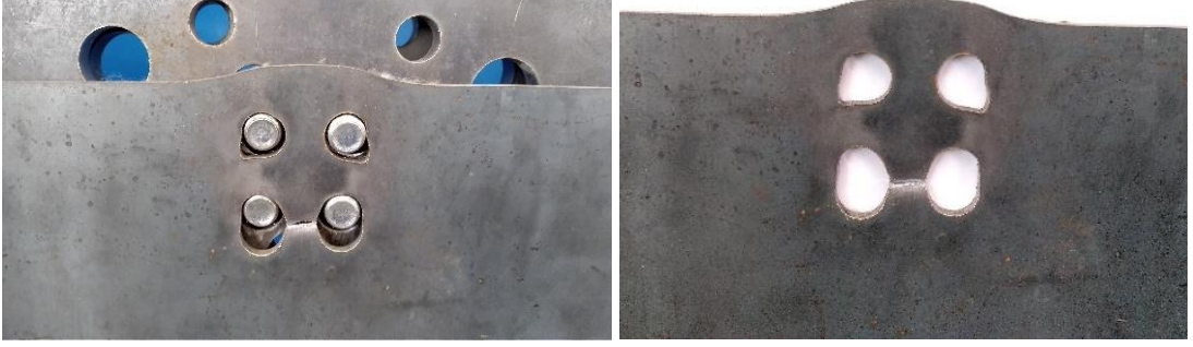
Şekil 5.23. 1 nolu noktada T1C deney numunesindeki hasar durumu
