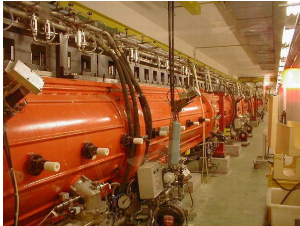
Şekil 2.1. Linac 2’de yer alan Alvarez tanklarının bir kısmı
