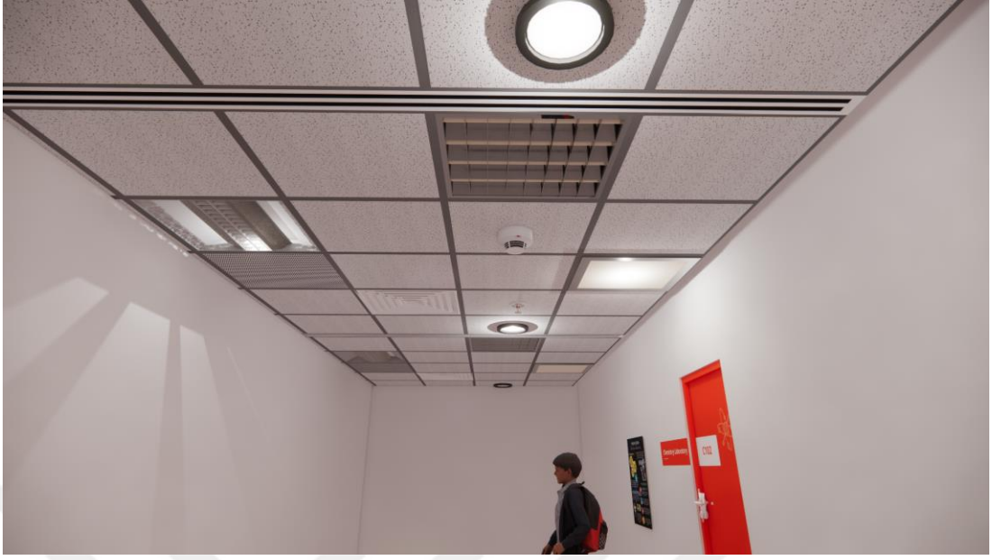
Şekil 48. OMÜ Fen Fakültesi yeni tasarlanmış aydınlatma sistemi
