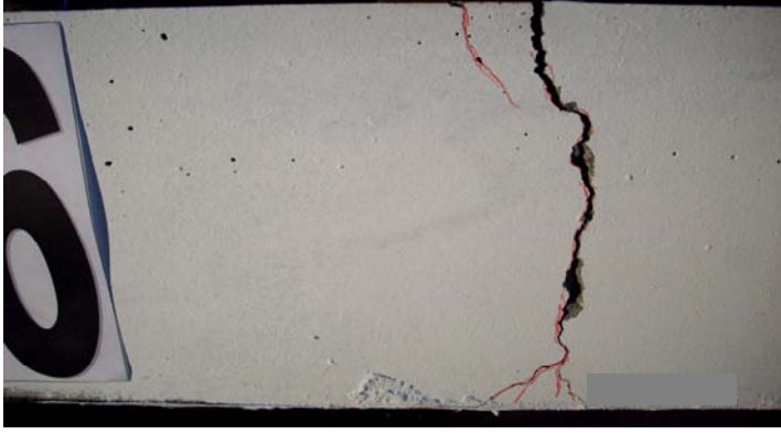
Resim 5.22. SC6 Elemanının göçme durumu
