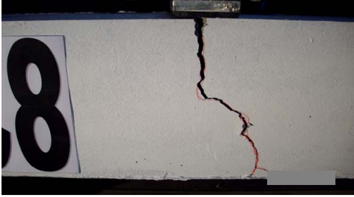
Resim 5.30. SC8 Elemanının göçme durumu
