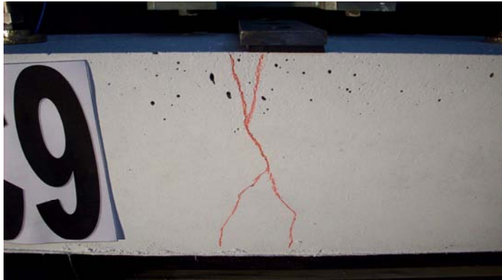
Resim 5.33. SC9 Elemanında oluşan ilk hasar
