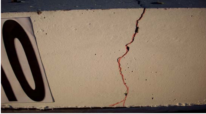
Resim 5.38. SC10 Elemanının göçme durumu
