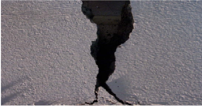
Resim 5.2. SC1 Elemanının göçme durumu
