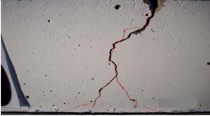
Resim 5.18. SC5 Elemanının göçme durumu
