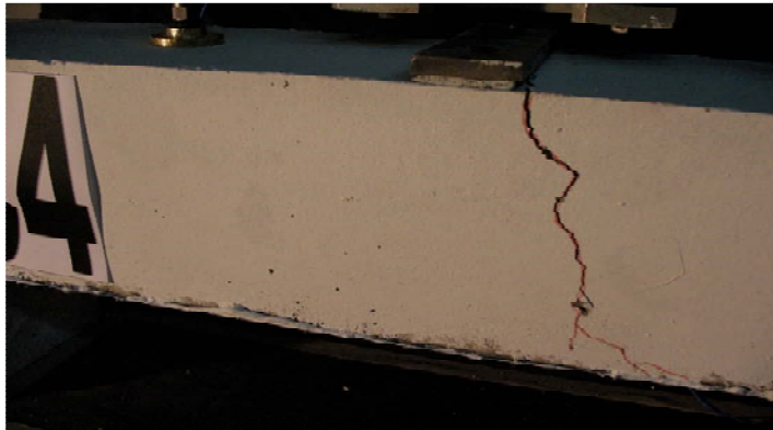
Resim 5.13. SC4 Elemanında oluşan ilk hasar
