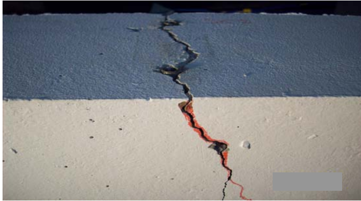
Resim 5.6. SC2 Elemanının göçme durumu
