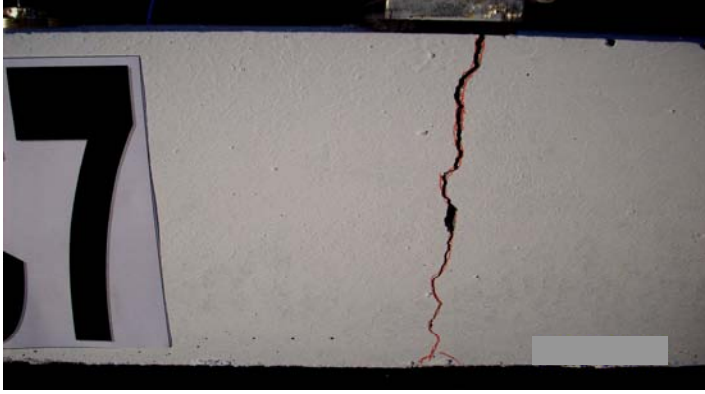
Resim 5.26. SC7 Elemanının göçme durumu
