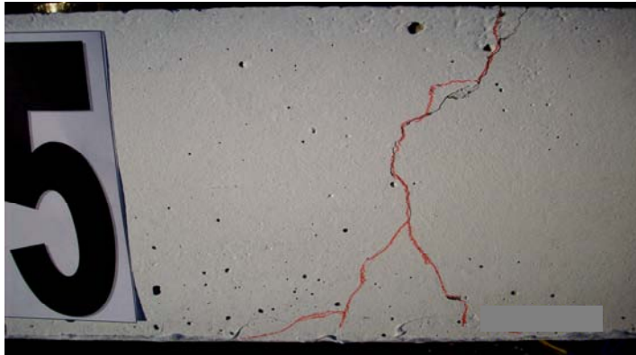
Resim 5.17. SC5 Elemanında oluşan ilk hasar
