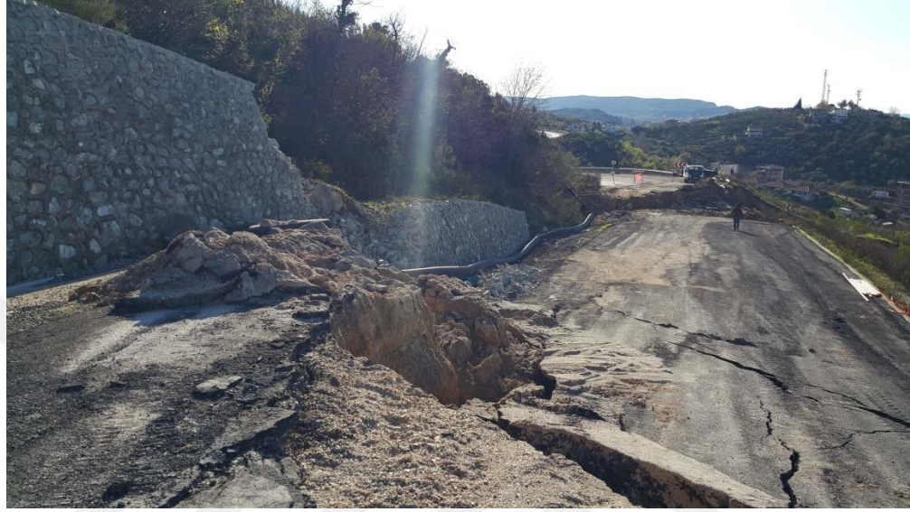
Şekil 3.4. Çınarcık-Esenköy yolunda meydana gelen heyelan.
