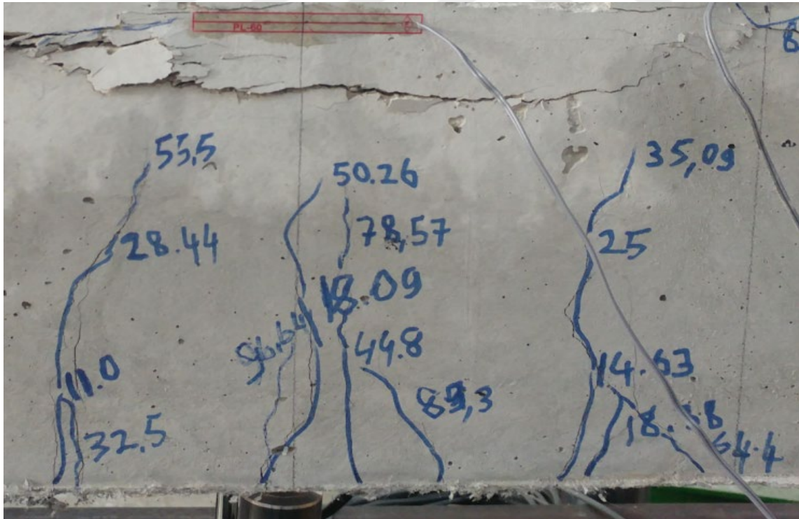
Şekil 4.27. ECCB-3 kirişi iki yük arası eğilme bölgesi çatlak gelişimi detay görünümü
