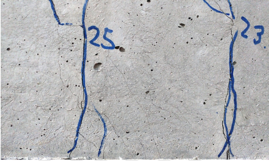
Şekil 4.28. ECCB-3 kirişi yük dışı eğilme bölgesi çatlak gelişimi detay görünümü
