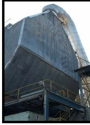
Şekil 6.5 Elektrofiltreler Akçansa A.Ş.
