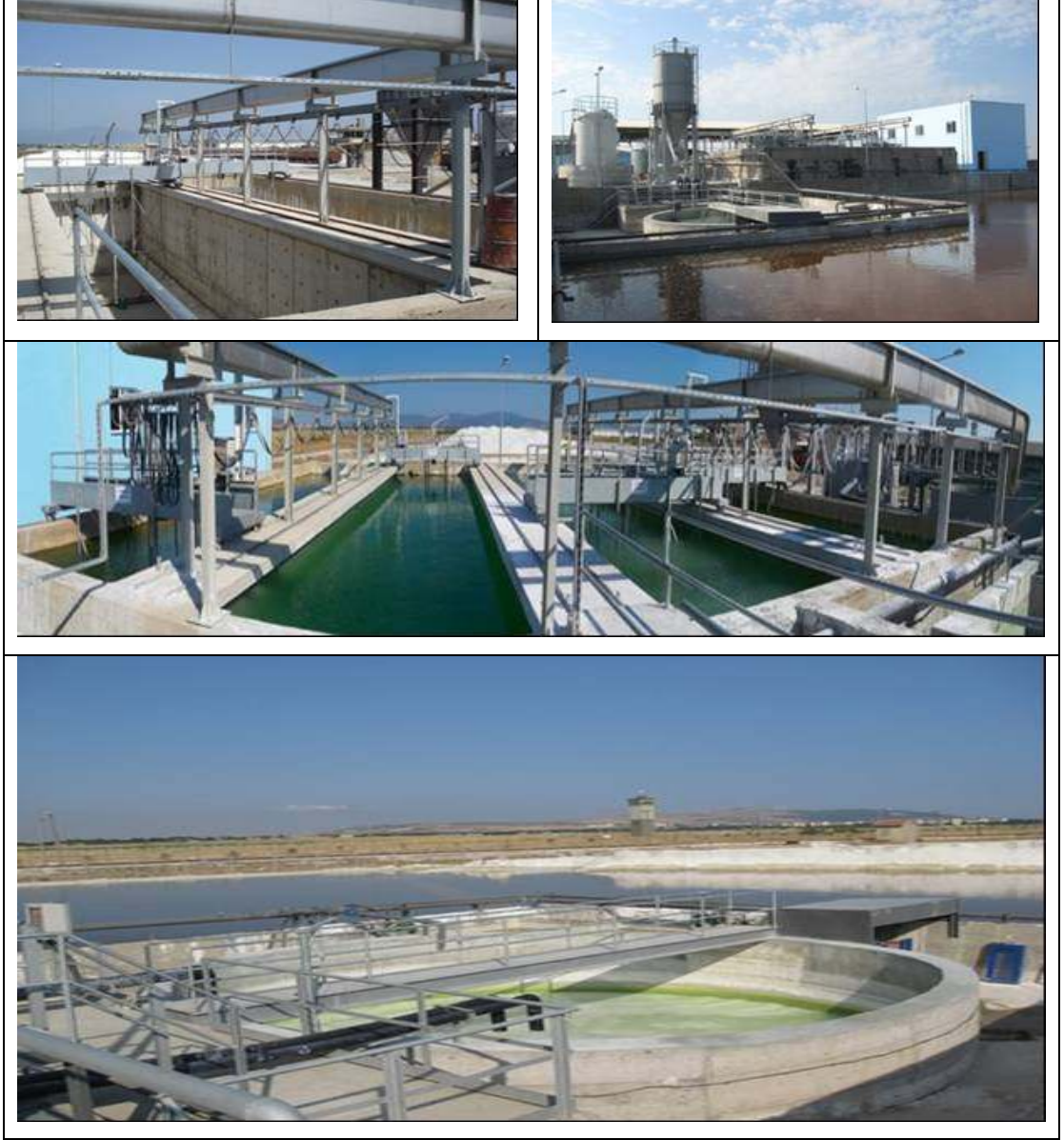
Resim 3.9. Atık arıtma tesisi
