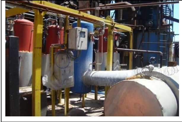
Resim 3.7. Pilot tesis ekipmanları (Buhar hattı, Soğutma hattı, Sıcaklık ve basınç otomasyon kontrol sistemi)
