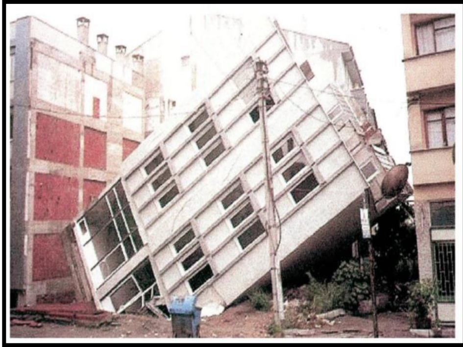
Şekil 16. Adapazarı'nda sıvılaşma sonrasında meydana gelen taşıma gücü kaybı ve oturma nedeniyle devrilen yapı (Yasuda, 2004).
