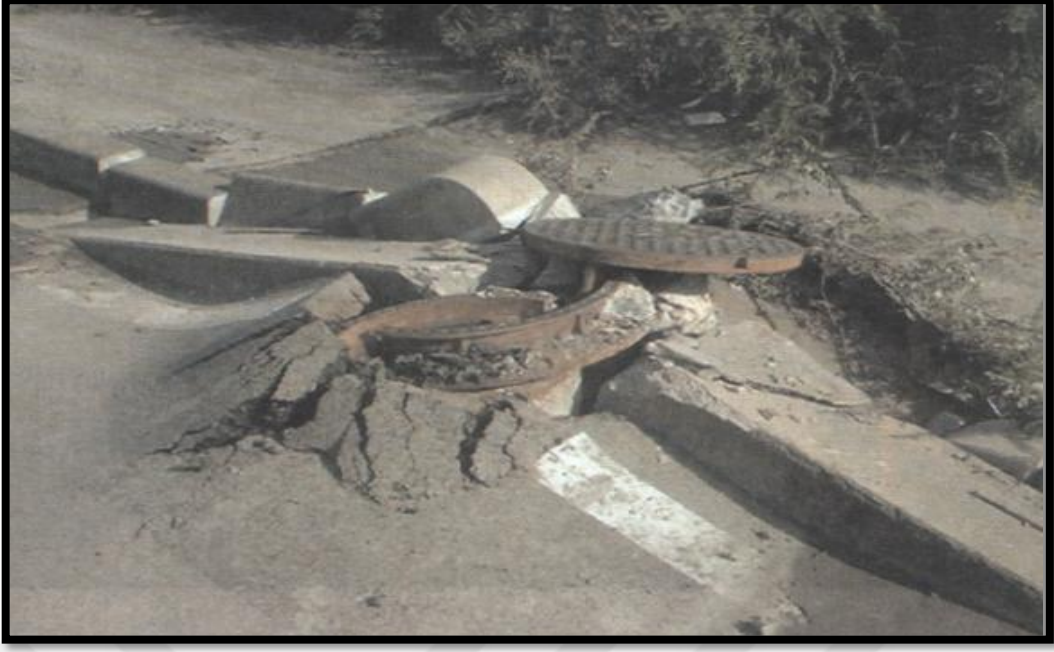
Şekil 19. 2000 Tottori depreminde sıvılaşma sebebiyle muayene bacasında oluşan hasar (Mollamahmutoğlu, & Babuçcu, 2006, s.71).
