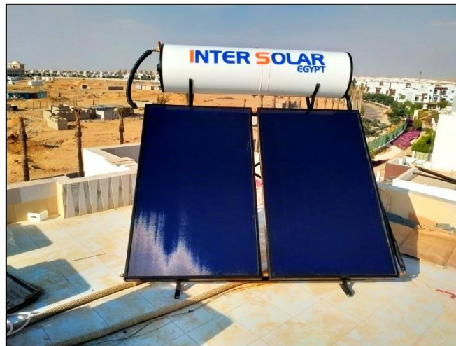
Şekil 2.5. Güneş enerjisi kollektörleri çatı uygulaması örneği
