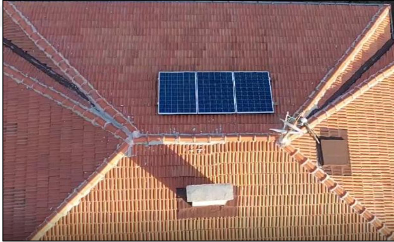
Şekil 4.4. 275Wp polikristal güneş panellerinin çatı konumu
