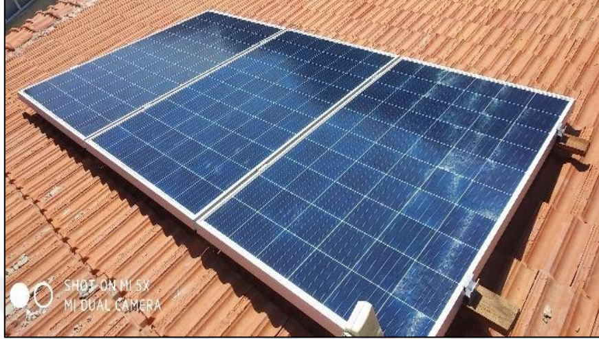
Şekil 4.5. 275Wp polikristal güneş panellerinin çatı montaj sistemi
