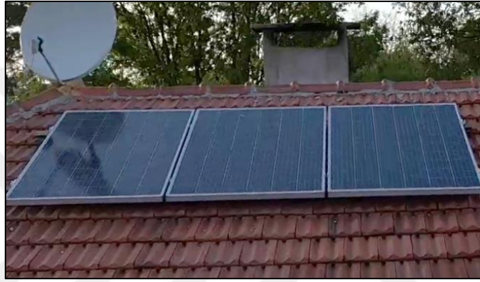
Şekil 3.2. Güneş panelinin gölgelenmesi
