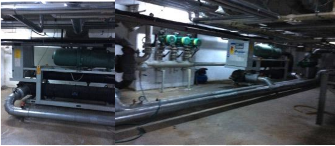
Şekil 36 : Otel İstıma Soğutma Sistem Odası
