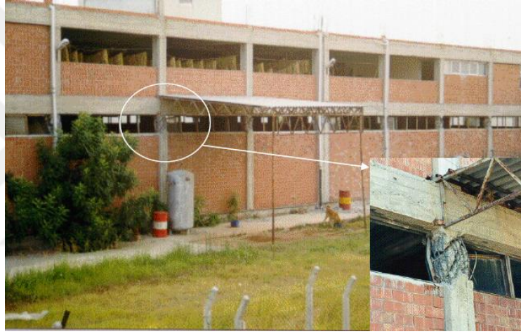
Şekil 3.24. Kısa Kolon Etkisi (Anonim, 2019)
