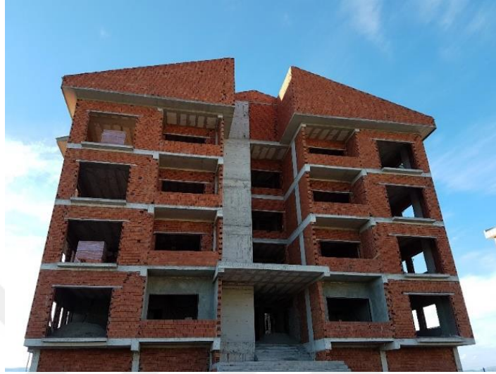
Şekil 3.39. 8. Blok İçin Yapılan İkinci Ölçümdeki Bina Durumu I
