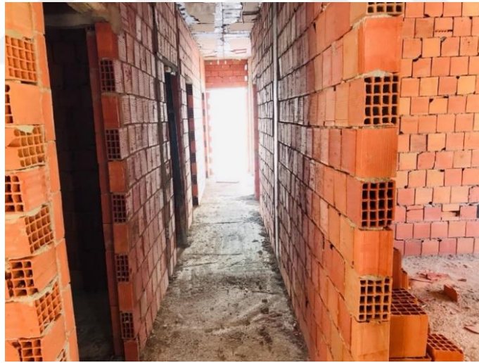
Şekil 3.40. 8. Blok İçin Yapılan İkinci Ölçümdeki Bina Durumu II
