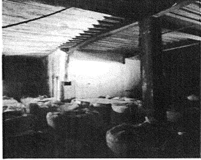
Şekil 3.43 Daire duvarının üstündeki kirişin deformasyonu sonucu oluşan burulması (Duvarın kaldırılmasının ardından)
