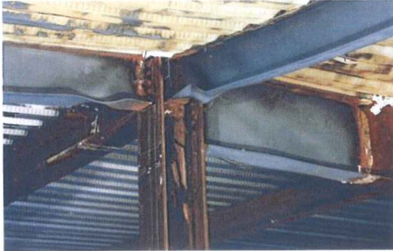
Şekil 3.30 Kiriş-kolon birleşiminin yakınında meydana gelen aşırı burulma
