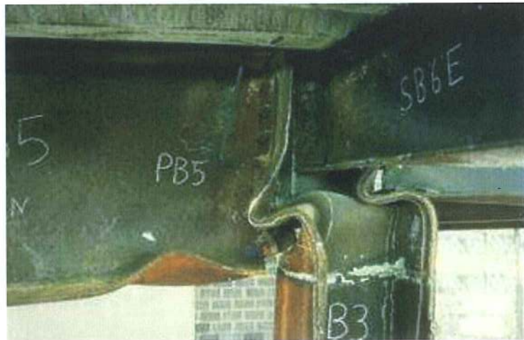
Şekil 3.19 Kolonun korunmasız kısmının ezilmesi (Not: Korumanın esas uzunluğu kolonun etrafındaki beyaz kalıntıdan tanımlanabilir.)
