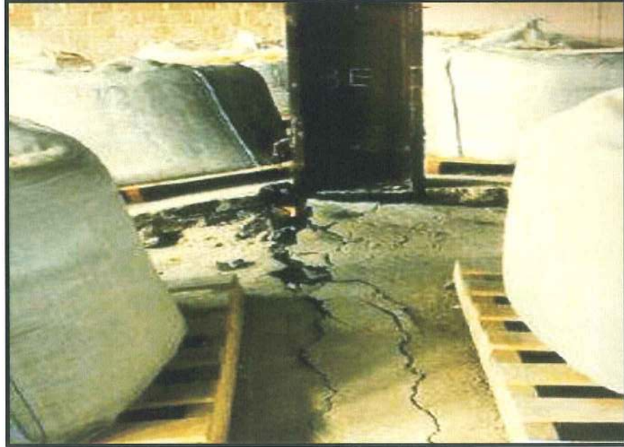
Şekil 3.57 İç kolonun çevresinde kompozit döşemenin çatlaması
