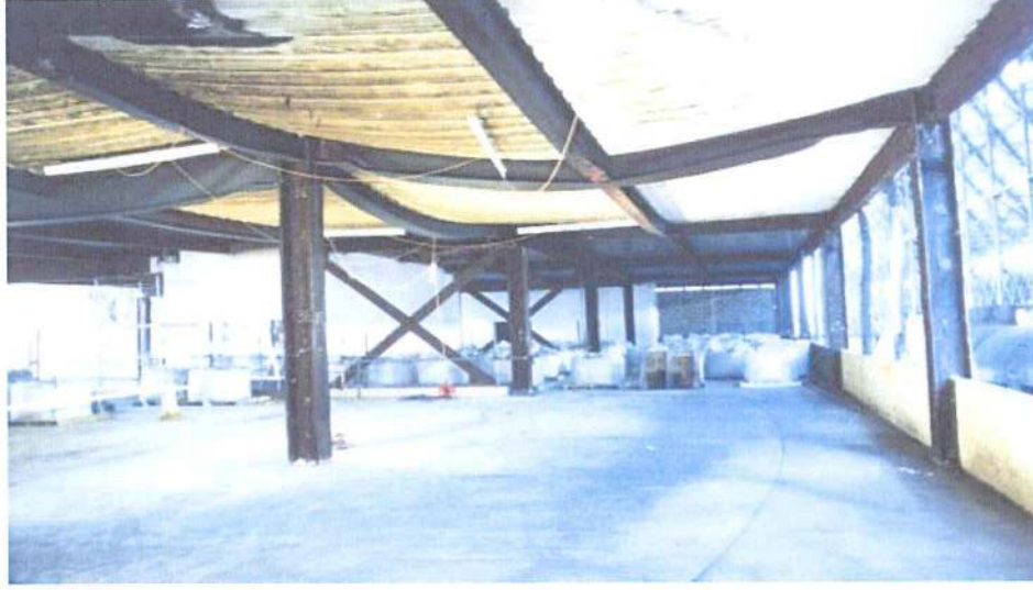
Şekil 3.29 Yangından sonraki yapısal deformasyon
