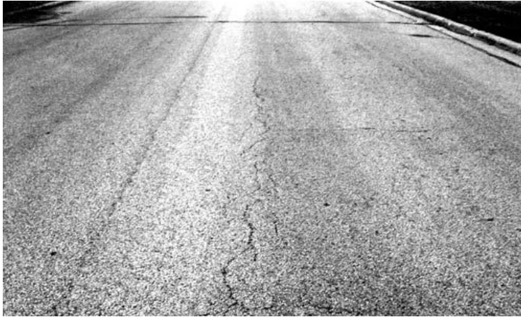
Şekil 2.8. Düşük şiddetli timsah sırtı çatlak bozulması (ASTM D6433-11 2011)
