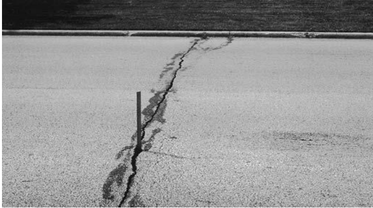
Şekil 2.31. Yüksek şiddetli boyuna – enine çatlak bozulması (ASTM D6433-11 2011)
