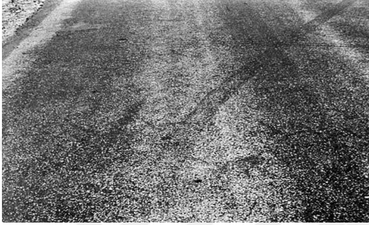
Şekil 2.11. Düşük şiddetli bitümlü bağlayıcı terlemesi bozulması (ASTM D6433-11 2011)
