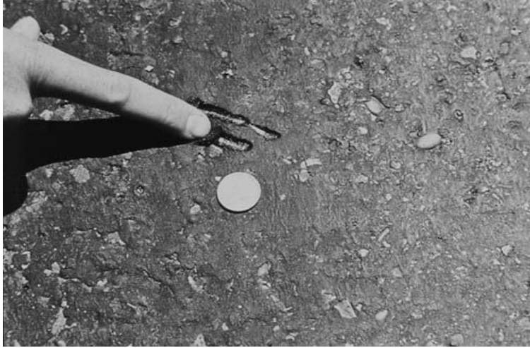
Şekil 2.13. Yüksek şiddetli bitümlü bağlayıcı terlemesi bozulması (ASTM D6433-11 2011)
