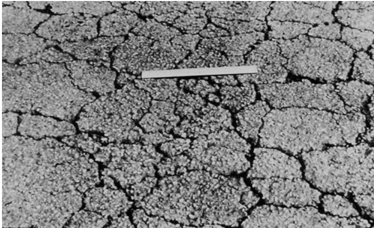
Şekil 2.10. Yüksek şiddetli timsah sırtı çatlak bozulması (ASTM D6433-11 2011)
