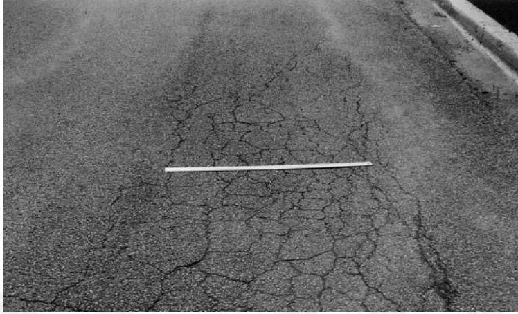
Şekil 2.9. Orta şiddetli timsah sırtı çatlak bozulması (ASTM D6433-11 2011)
