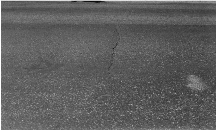
Şekil 2.29. Hafif şiddetli boyuna – enine çatlak bozulması (ASTM D6433-11 2011)
