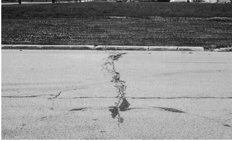
Şekil 2.30. Orta şiddetli boyuna – enine çatlak bozulması (ASTM D6433-11 2011)
