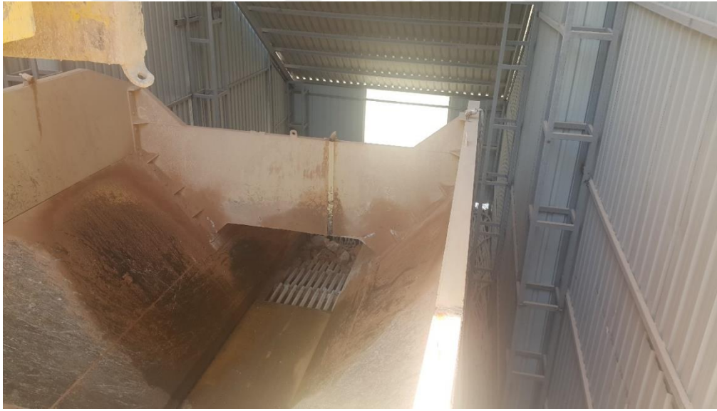
Şekil 4.8 Bunker sistemi (Kişisel arşiv, 2019)
