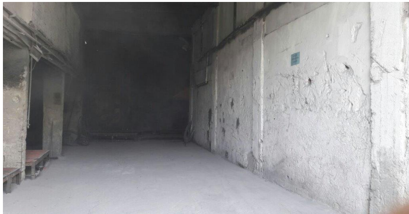
Şekil 4.14 Sızdırmaz beton zeminli tehlikeli atık kabul alanı (Kişisel arşiv, 2017)
