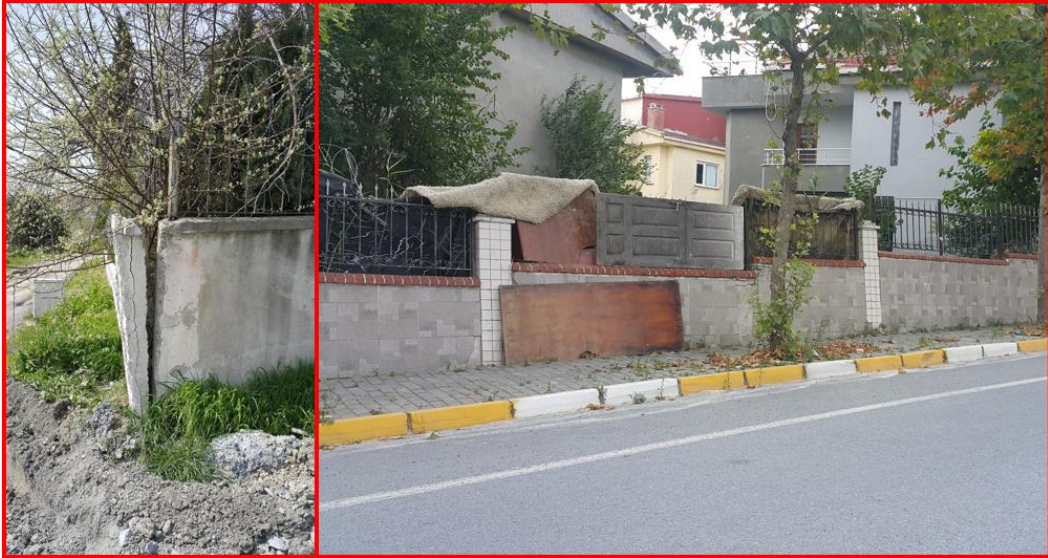
řekil 4.5 alıřma alanında bulunan binalarda meydana gelen deformasyonlar.
