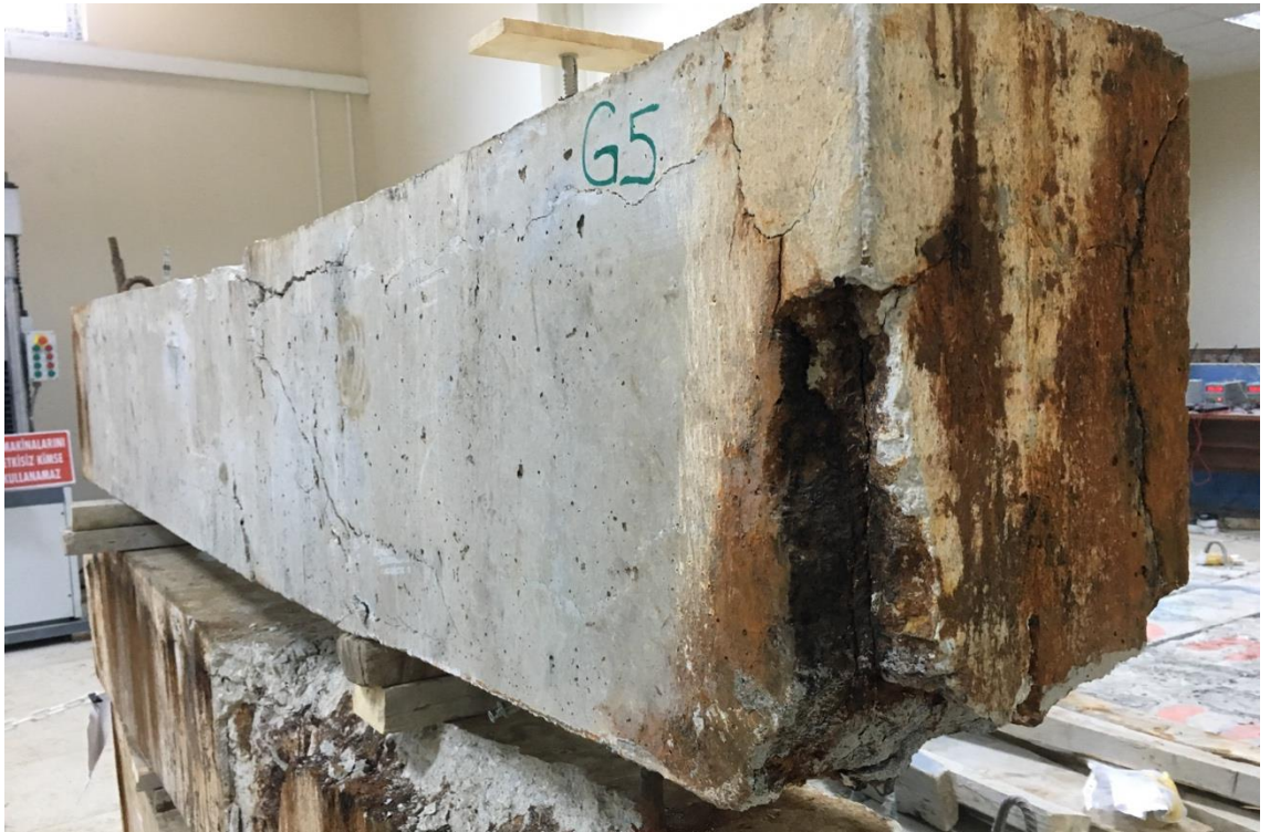
Şekil 5.24. G5 Kırım Sonrası Detaylı Çatlak Desenleri
