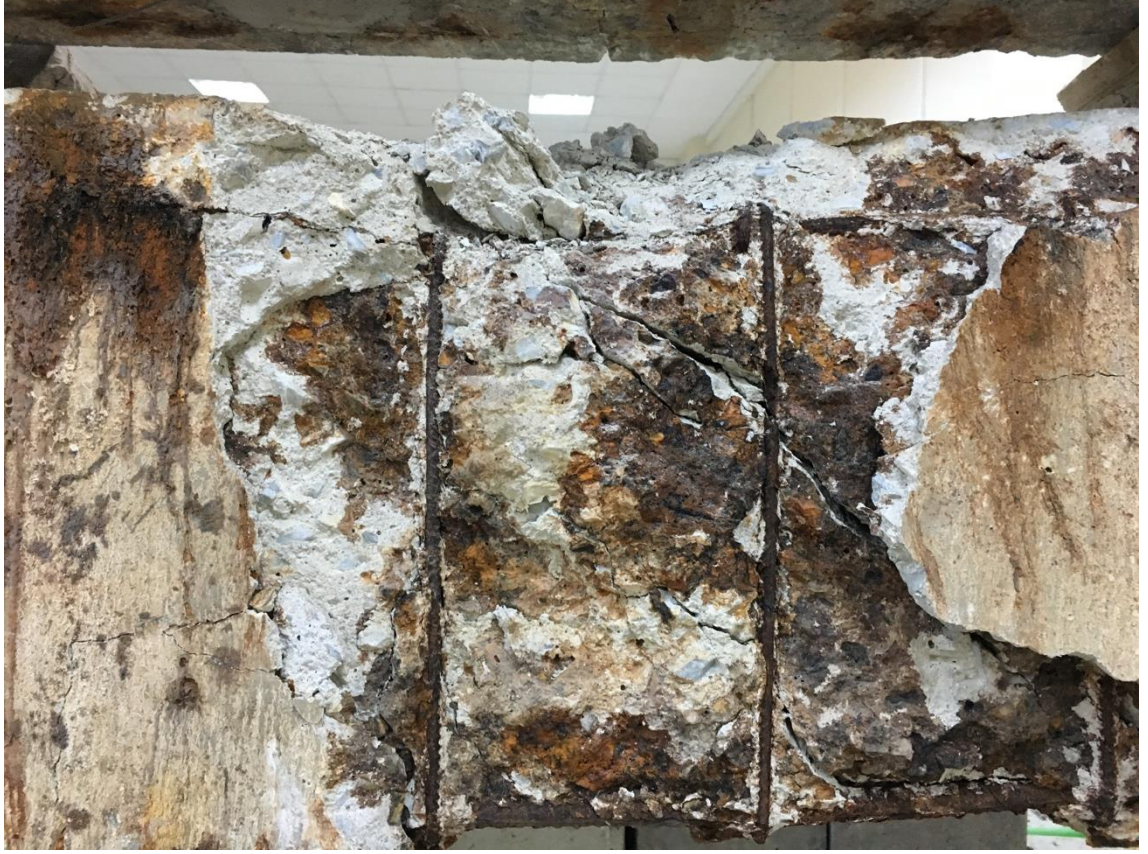
Şekil 5.23. C5 Kırım Sonrası Detaylı Çatlak Desenleri
