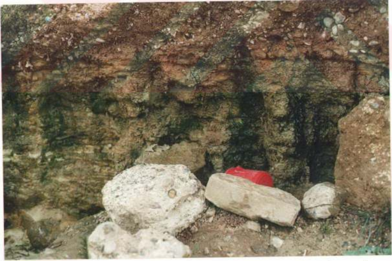
Şekil 1.4.1. İstasyondaki drenaj suyunun depolama sahasında meydana getirdiği sızıntının görünümü
