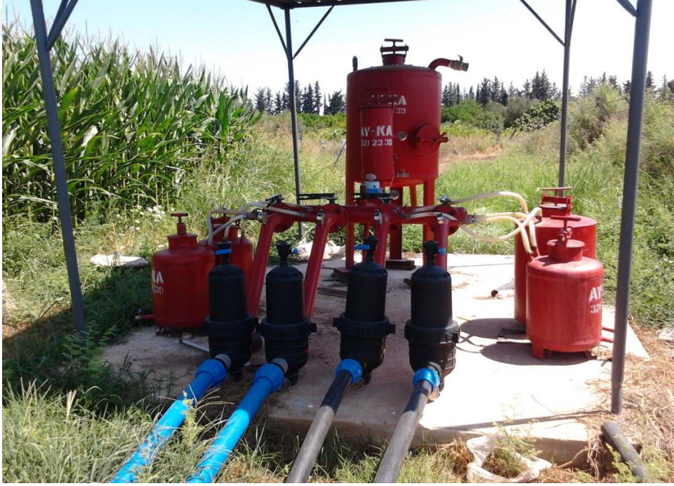
Şekil 3.4. Deneme alanındaki damla sulama sisteminin genel görünümü
