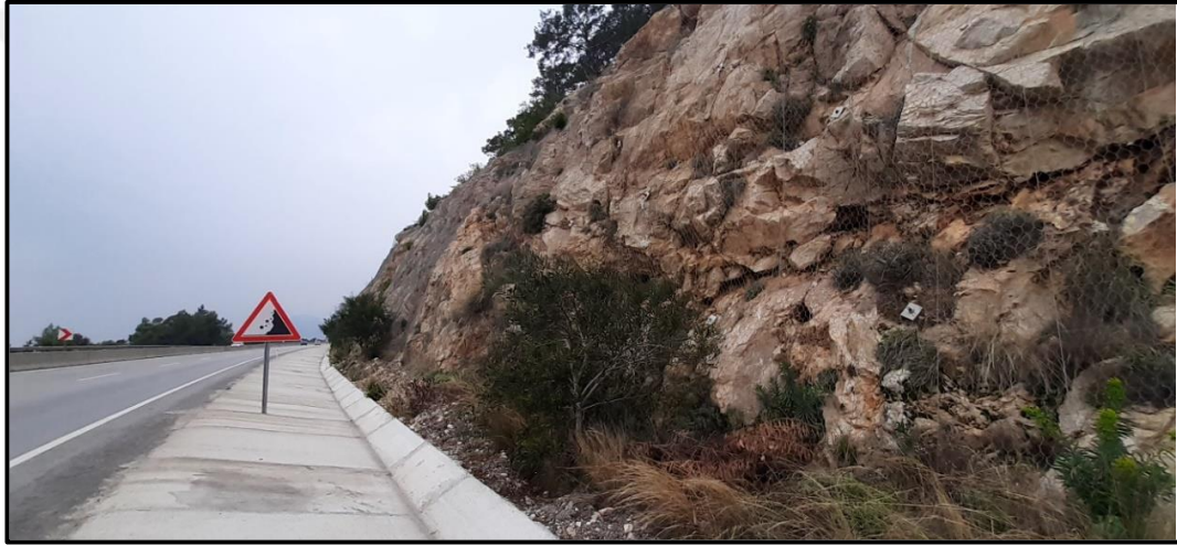
Şekil 4.5. Bölgenin kaya düşmelerine duyarlı olduğunu gösteren uyarı levhası
