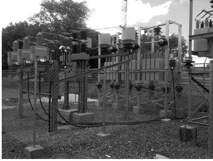
Şekil 3.12. Dağıtım trafo merkezindeki kondansatör bankaları [87].
