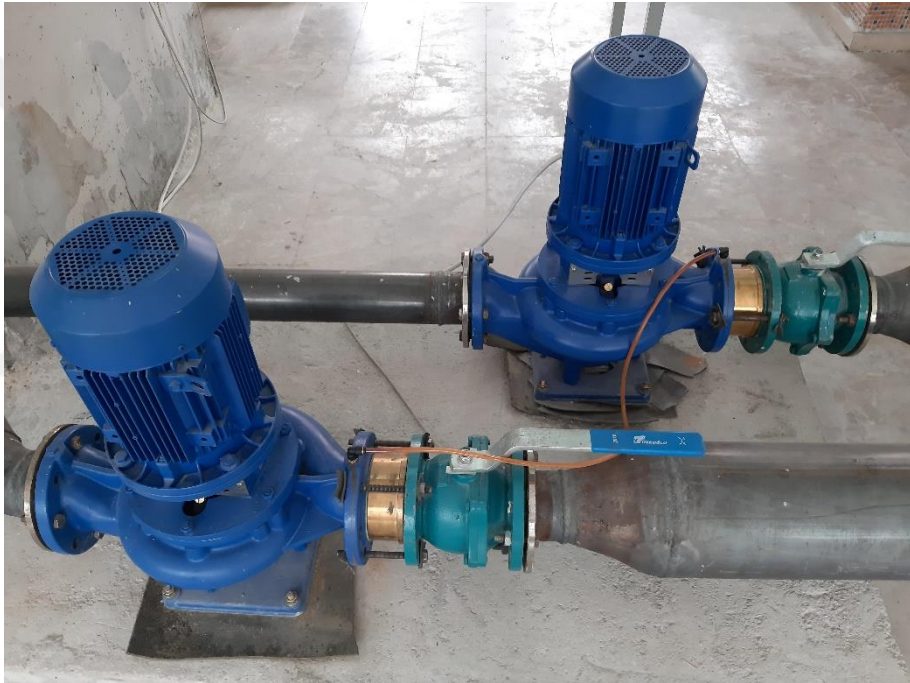
Şekil 4.46. Açık kanal sistemine su sağlamak için kullanılan pompalar
