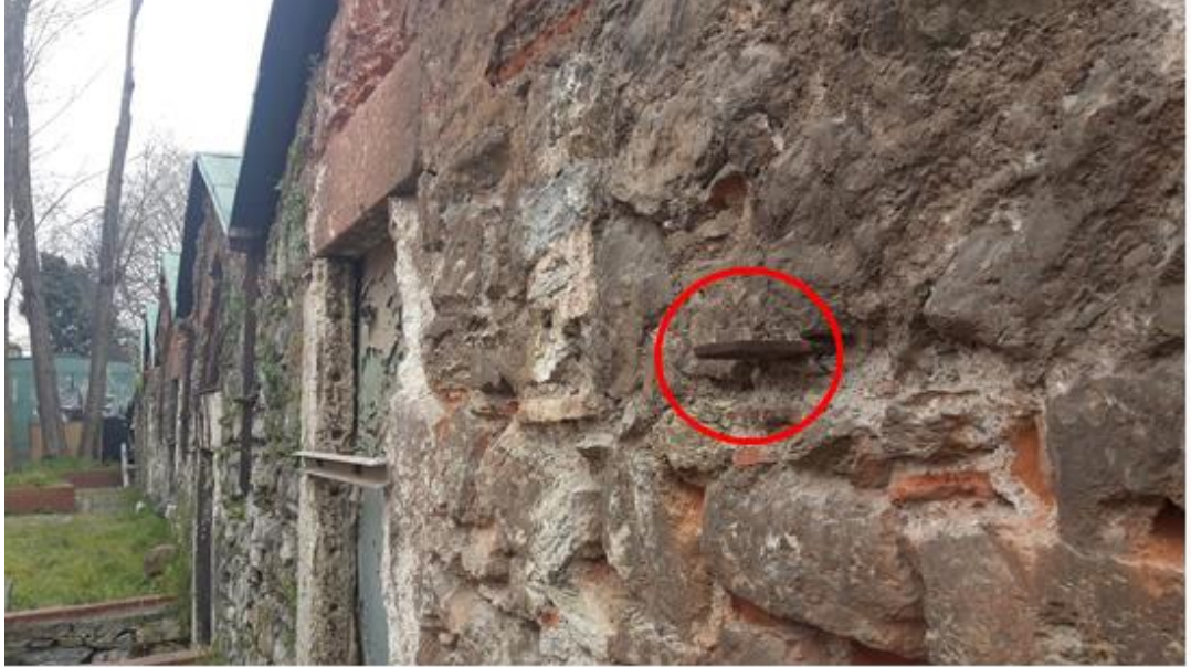
Şekil 4.22 15 numaralı yapı güneybatı cephesinde boştaki kılıçlama elemanı.
