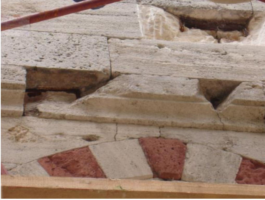
Şekil 2.8 Yavuz Sultan Selim Camii cephesinde demir kenetler.
