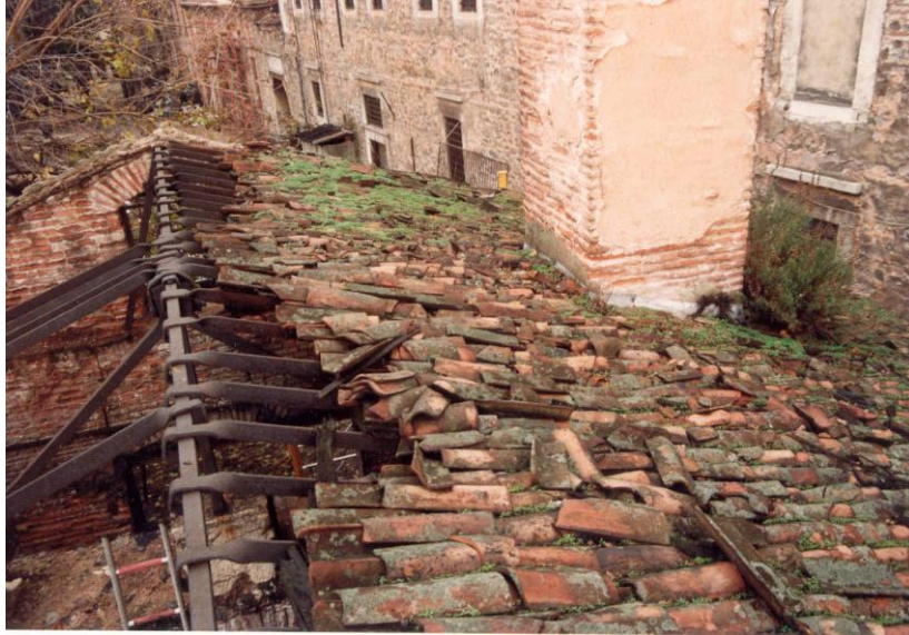
Şekil 4.81 14 numaralı yapının 1996 yılı onarımı öncesi çatı strüktürü ve üst kaplaması[36].
