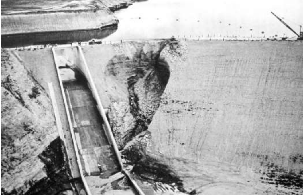
Şekil 3.2. Fontenelle Barajı'nda sızma sonucunda gövdede yıkılma.
