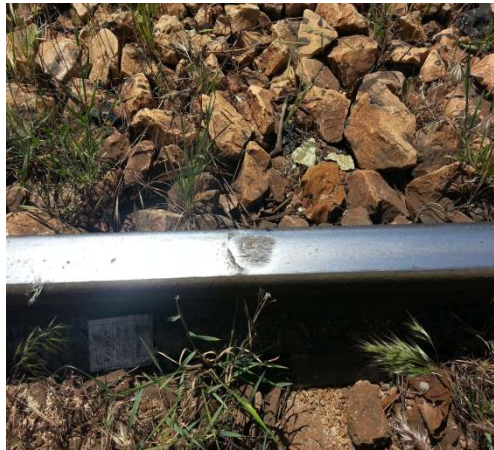
Şekil 2.3. Raylarda apletlik arızası
