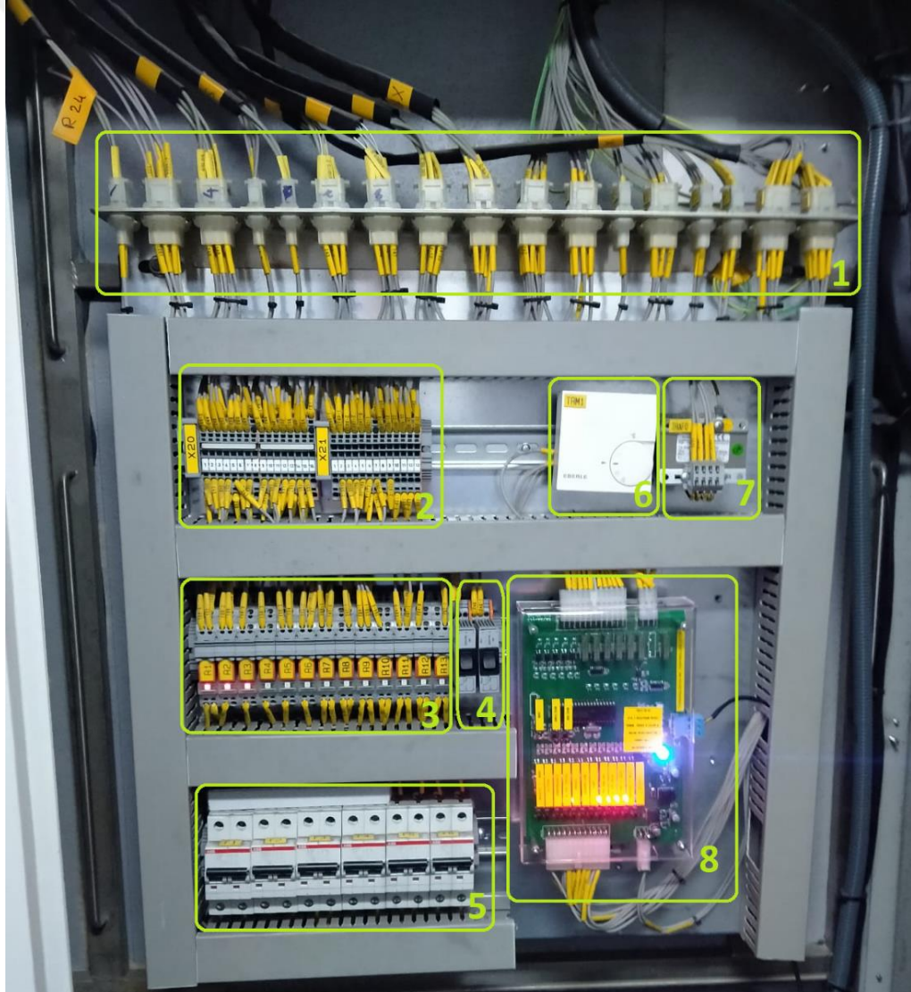
Şekil 3.3. VTS elektrik paneli.
