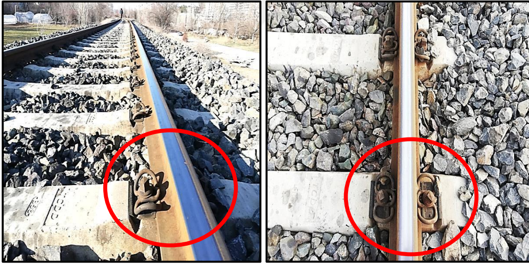
Resim 1.2 Ray Bağlantı Elemanlarının Demiryolu Üzerindeki Görünümü
