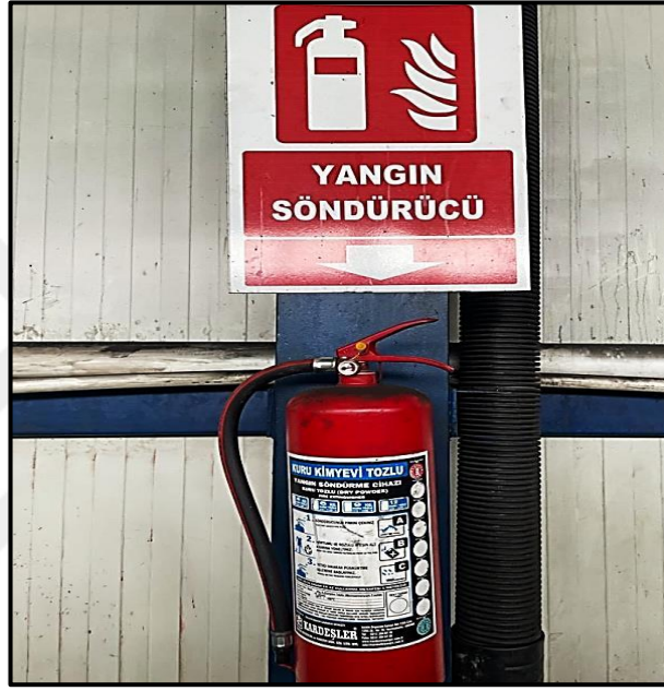
Resim 4. 11 İmalat Bölümünde Yer Alan Yangın Tüpü
