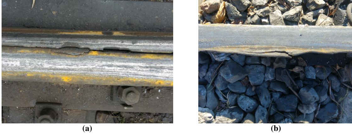
Şekil 2.11. Ray mantarında oluşan düşey çatlaklara ait örnek görüntü
