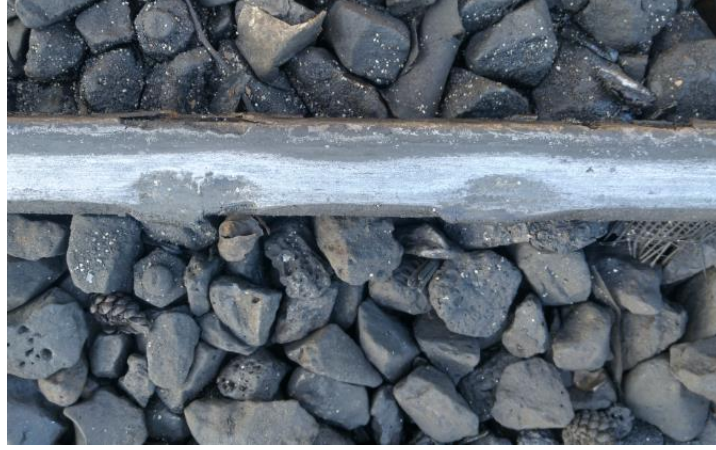
Şekil 2.19. Ray yüzeyinde oluşan tekrarlı tekerlek yanığı görüntüsü
