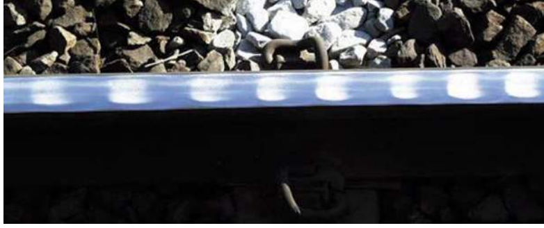
Şekil 2.12. Ray yüzeyinde oluşan kısa dalga boylu ondülasyon görüntüsü [124].
