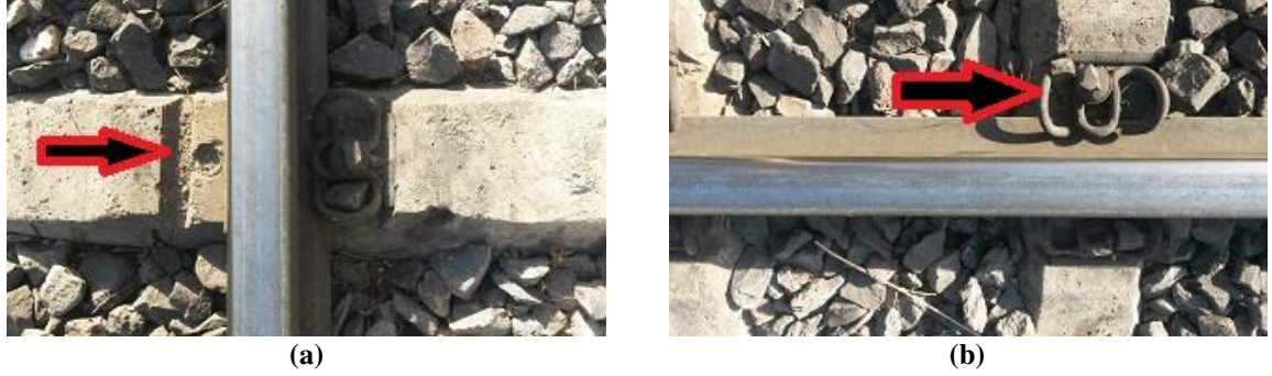
Şekil 2.27. Bağlantı bileşeni arızaları (a) Bağlantı elemanının çıkması (b) Bağlantı elemanının gevşemesi
