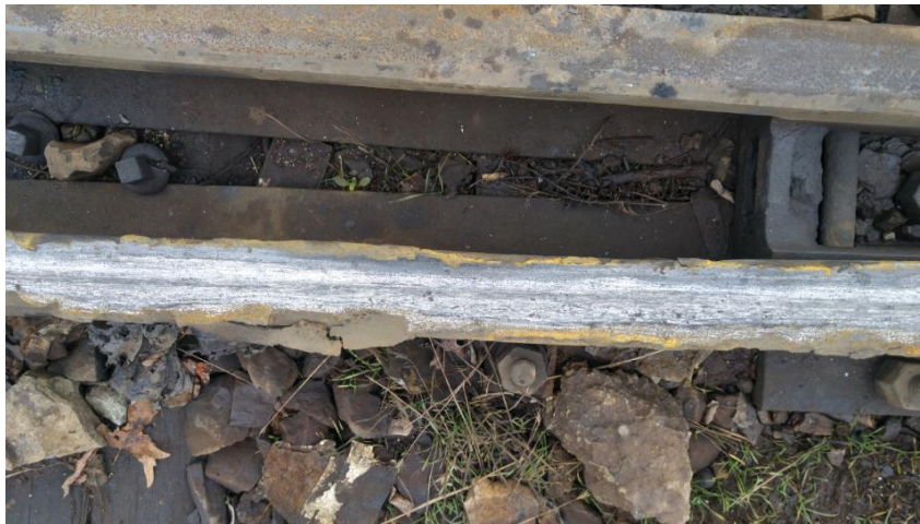
Şekil 2.16. Ray yüzeyindeki kabuklanma arızasına ait örnek görüntü
