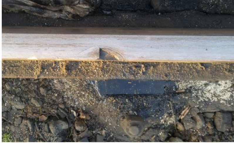
Şekil 2.9. Ray mantarında oluşan oval boşluk arızasına ait örnek görüntü
