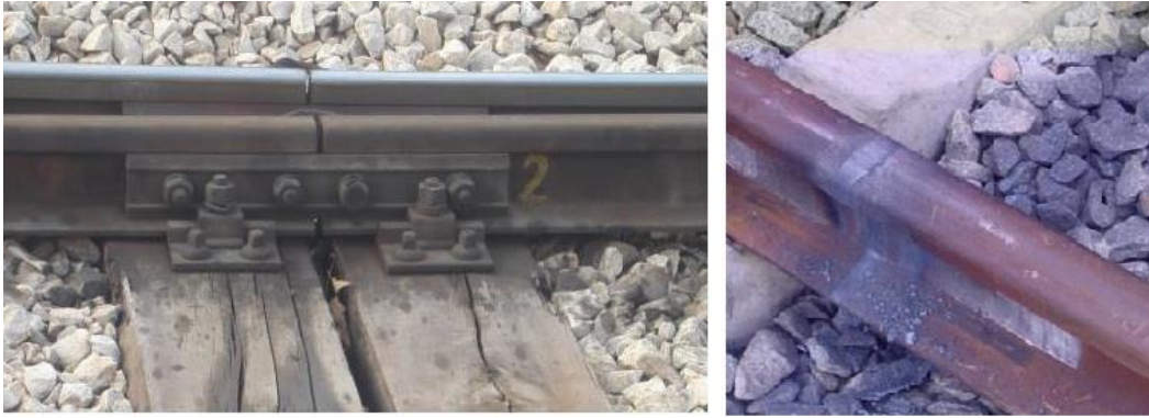
Resim 4.7 Rayı raya bağlayan cebire bağlantı elemanı ve ray kaynağı örneği.
