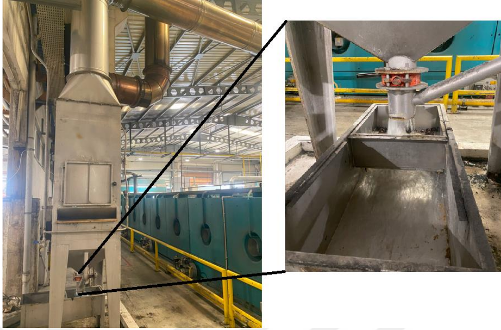
Şekil 4.37. Baca Gazı Soğutma Suyu
