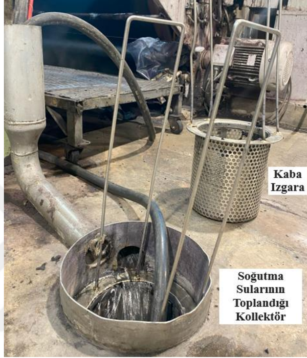
Şekil 4.36. Soğutma Sularının Toplanması
