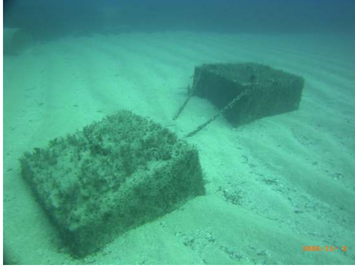
Şekil 3.16 Deniz deşarjı hattında büyük rehabilitasyon gerektiren hasar.
