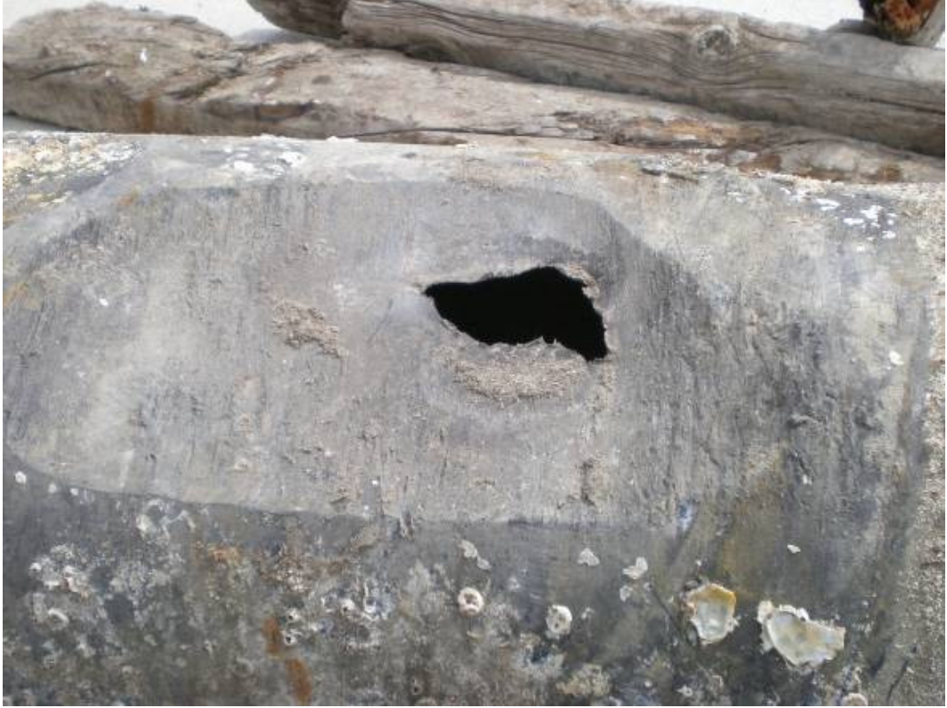
Şekil 4.3 Hasar sonrası deşarj borusu
