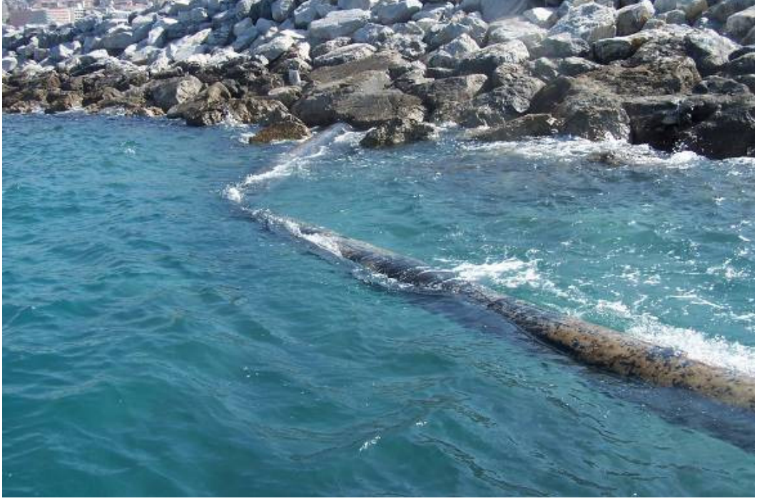
Şekil 4.2 Hasar sonrası deşarj borusu
