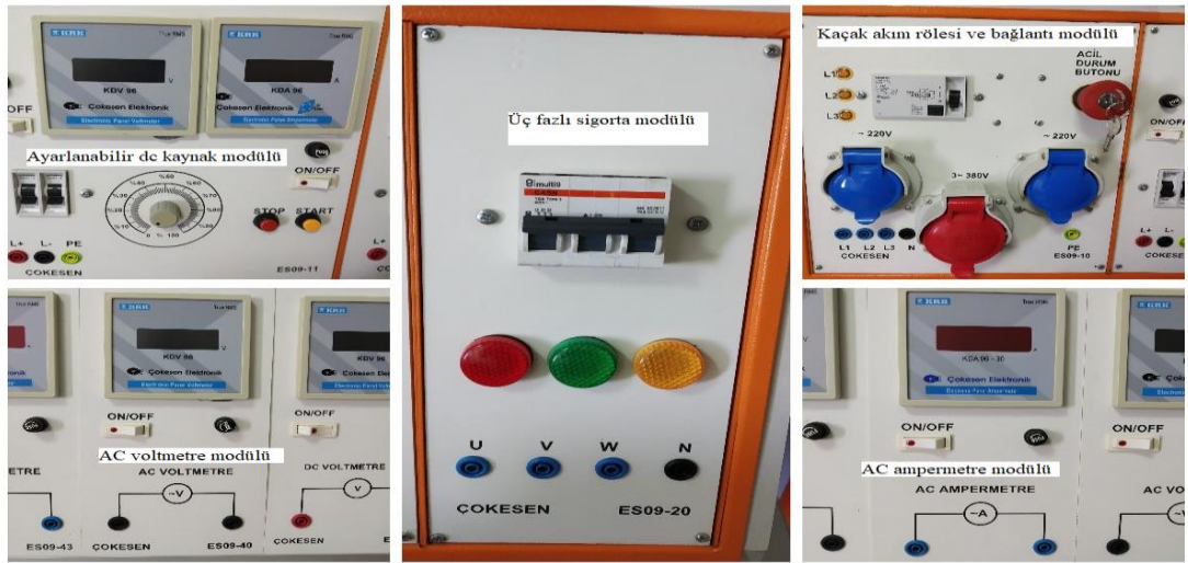
Şekil 3.23 Kaçak akım rölesi ve bağlantı modülü, AC ampermetre modülü, ayarlanabilir dc kaynak modülü, AC voltmetre modülü, üç fazlı sigorta modülü (Kişisel arşiv, 2021)
