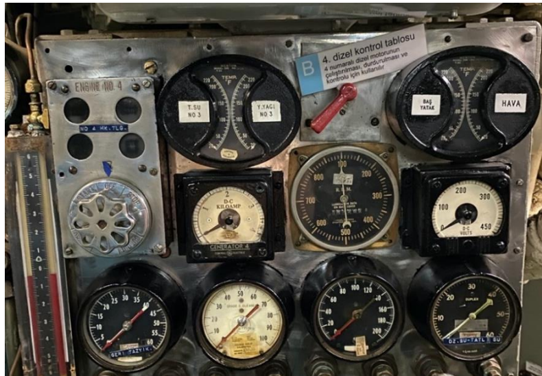
Şekil 3.30: Kıç dizel makine dairesinde kullanılan makine kontrol panolarının bir fotoğrafı.
