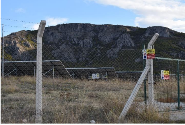
Şekil 2. 13. Güneş Enerji Santralleri Bölgesi (Orijinal, 2024)
